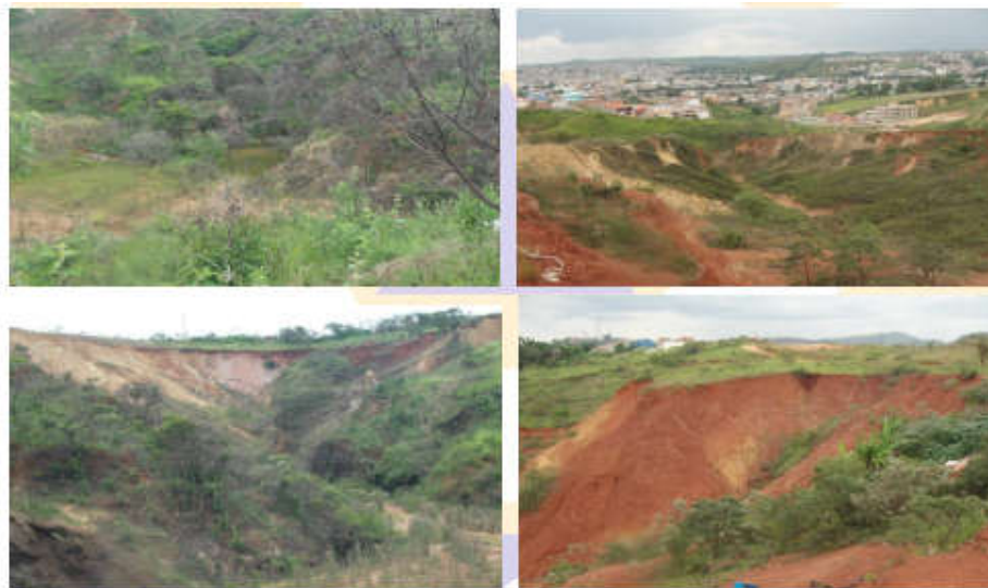
Figura 07: Voçoroca Rua Fidélis Guimarães e Vila Lombardi Fonte: Defesa Civil, 2013
